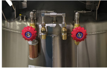
LN 2 Fill Valve
